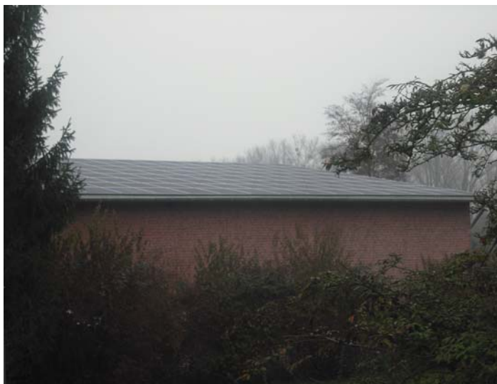
Abb.: Fertige Fotovoltaikanlage
